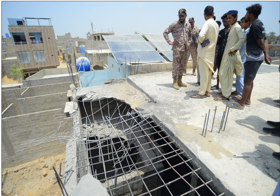
5月8日,人们在巴基斯坦卡拉奇的印度无人机袭击现场检查受损的房屋。
